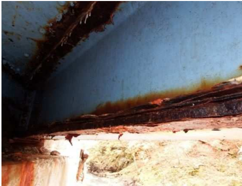
写真 4.8.29 上部構造(主桁)の腐食状況
