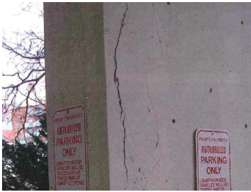
写 4.3.1 鋼材軸方向のひびわれ 24
