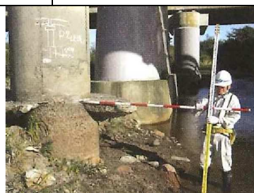
《基礎の洗堀状況》 7
