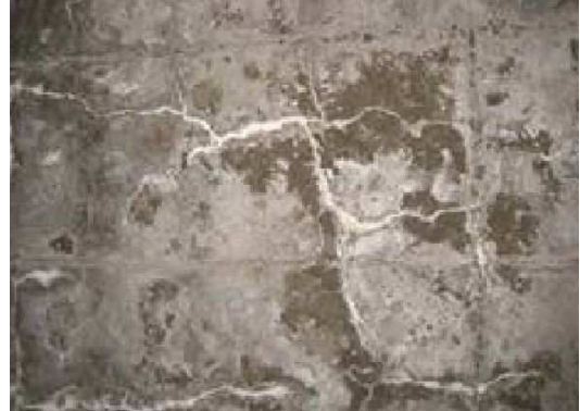
写真 4.8.27 床版下面ひびわれ状況近接
