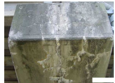
写 4.3.9 膨張ひびわれ(亀甲状)
