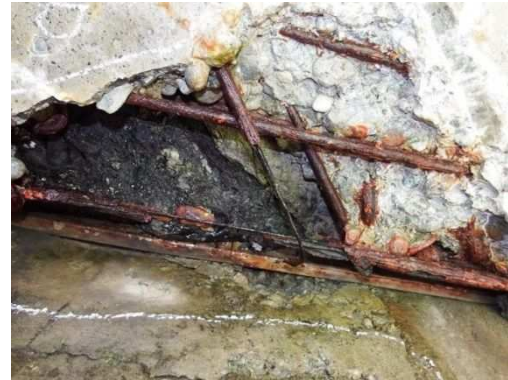
写真 4.8.30 床版の抜け落ち状況
