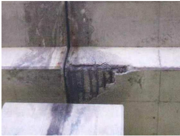
写 4.3.4 部材の断面欠損 25
