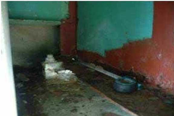
写真 4.8.22 主桁ウェブと下フランジ腐食状況
