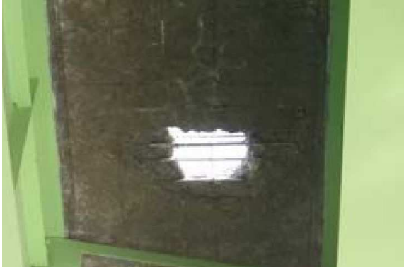
写真 4.8.26 床版の抜け落ちた様子
