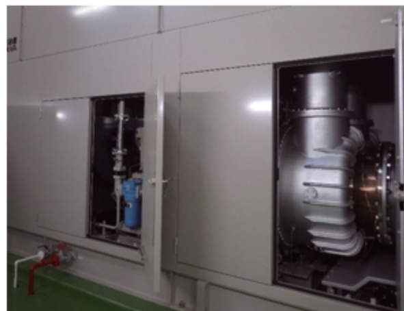
発電機内部(ガスタービン機関)
