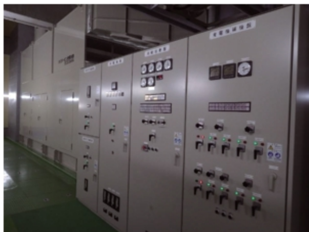
発電機(奥)と制御盤(手前)
