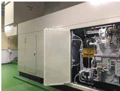
大久保浄水場自家用発電機設備 発電機 3,600kW (さいたま市)
