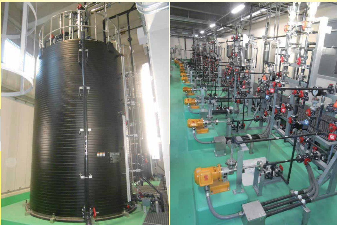
【庄和浄水場次亜塩素酸ナトリウム注入設備】
