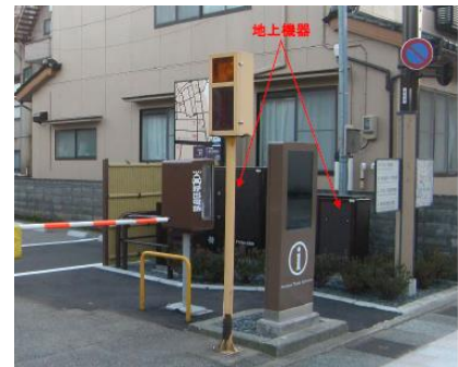
私有地を活用した地上機器の設置 (国土交通省HPより)
