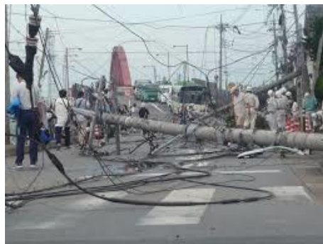
越谷市における竜巻による電柱倒壊 (内閣府HPより)
