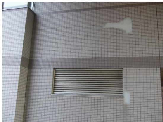
行政棟外壁タイル剥離状況
