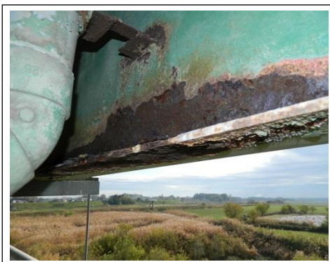
橋桁劣化事例
