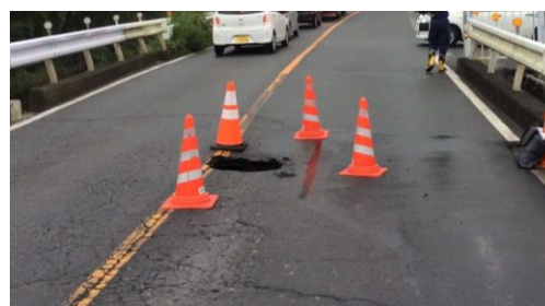
県管理道路における陥没事例
