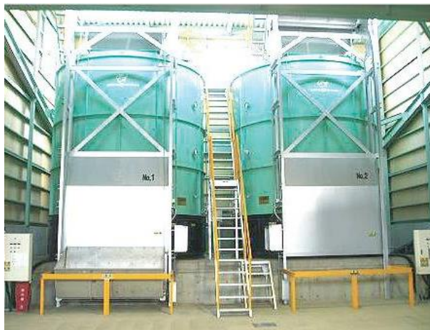
食品残さ発酵槽（2基）
