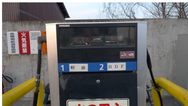
BDF給油スタンド（(株)武蔵野物流内）
