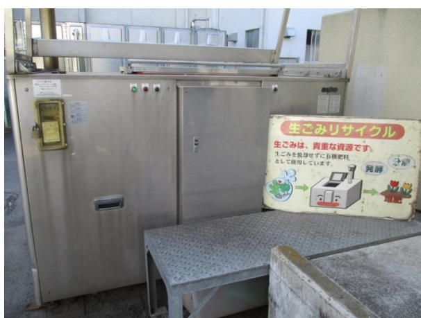
生ごみ処理機外観
