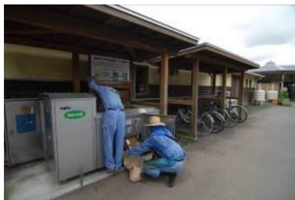
施設裏にある生ゴミ処理機
