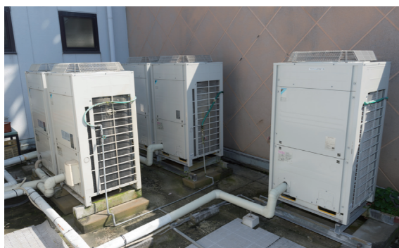
高効率な空調設備
