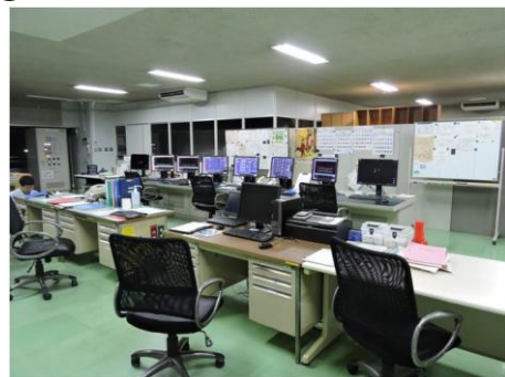
①中央監視室
