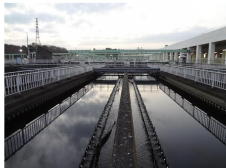
⑥最終沈殿池
