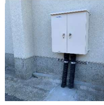
【体育館空調設備用電源盤】
