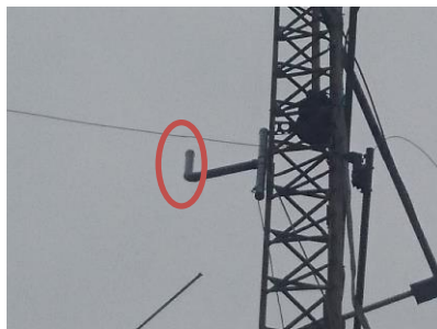
水位計受信機（高さ15m）
