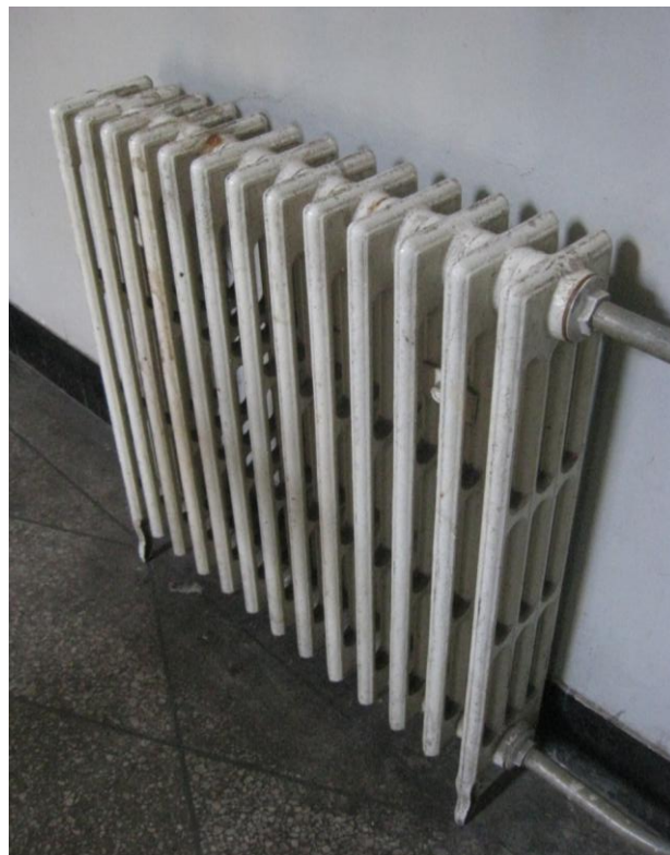
大学内の廊下に設置されている暖气 （教室内だけでなく、廊下、トイレにも設置されています。触れると暖かい程度なので、むき出しであっても危険ではありません。）
