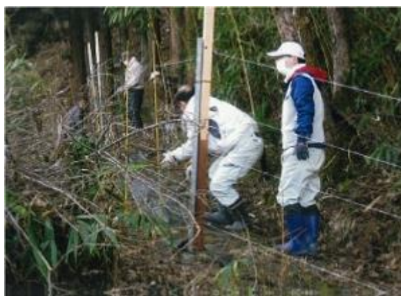
地域で連携して設置する広域防護柵
