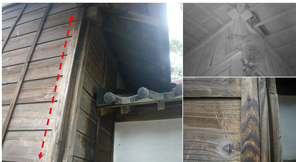
建物への侵入経路（左）、建物に侵入したアライグマ（右上）、爪痕（右下）
