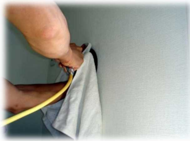
圧縮空気による清掃 (通常は出来ない)
