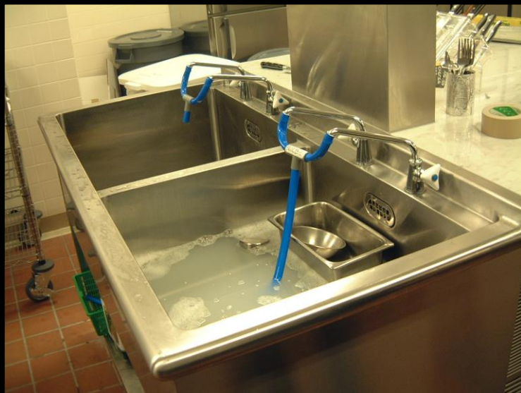
厨房内の流しの水栓
