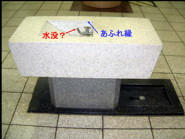
地下鉄構内の水栓
